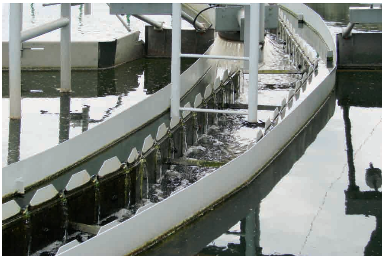
ČOV Bohumín – hřebenový přepad dosazovací nádrže
