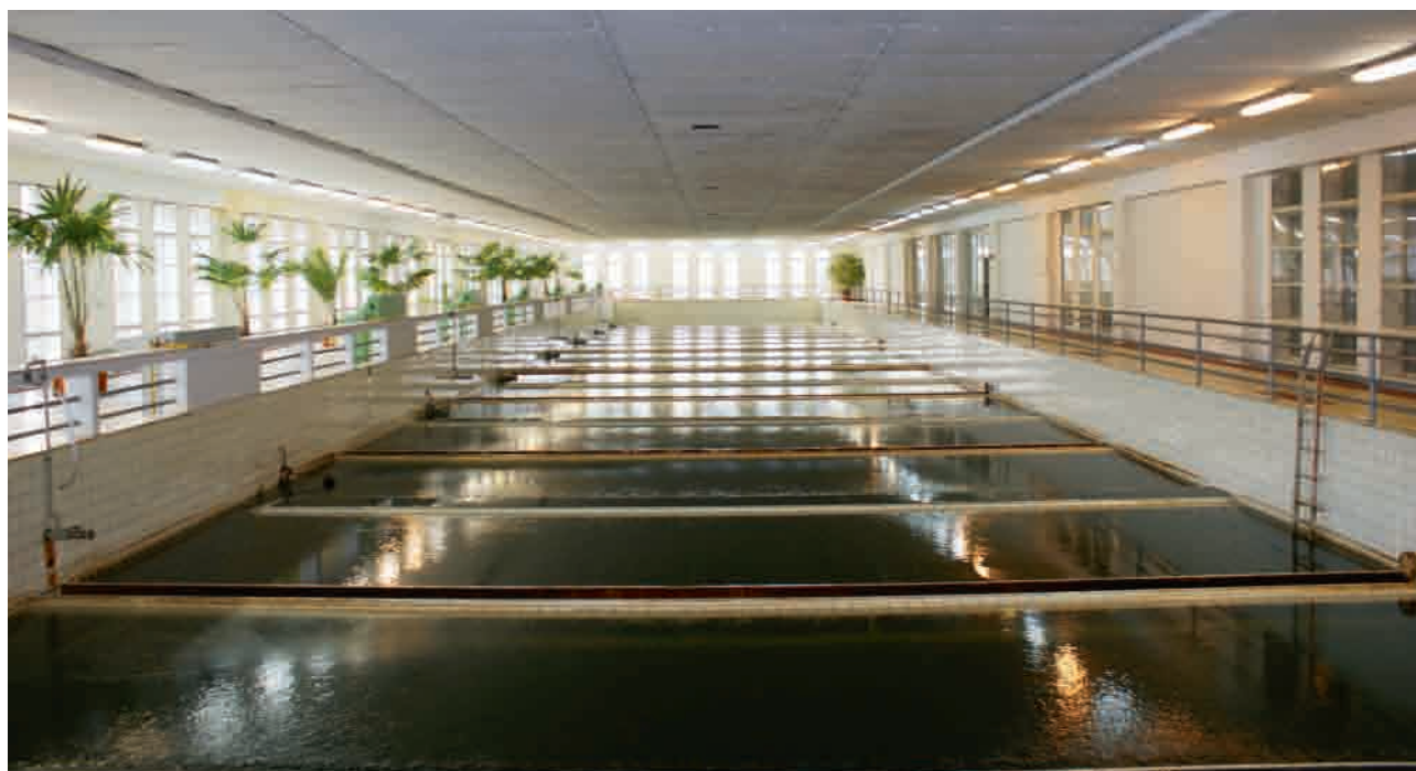
Úpravna Podhradí – filtry
